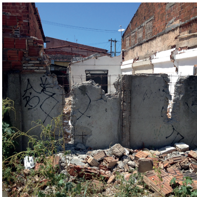
Figura 8: Entulhos na comunidade do Mucuripe
