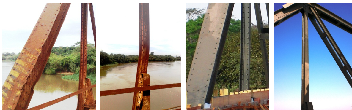
FIGURA 5: ELEMENTOS DANIFICADOS POR IMPACTO (ANTES E APÓS RECUPERAÇÃO)
