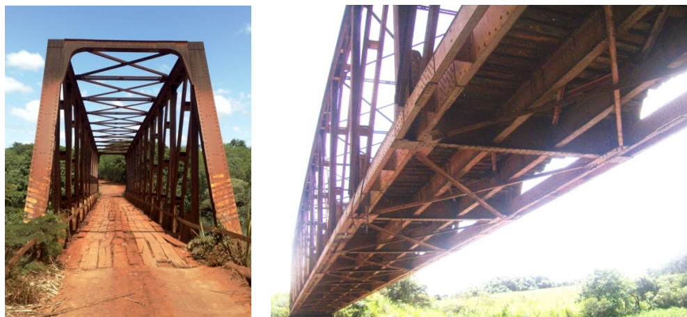
FIGURA 4: ESTADO DA PONTE ANTES DA RECUPERAÇÃO
