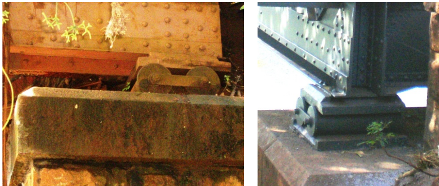
FIGURA 3. APARELHO DE APOIO METÁLICO DESLIZANTE (ANTES E APÓS RECUPERAÇÃO)
