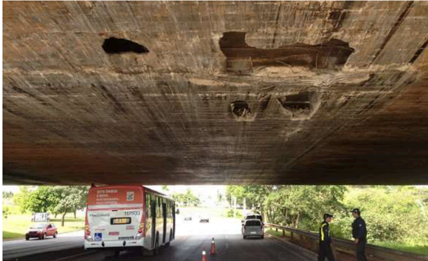
Figura 12: Danos na laje inferior do caixão perdido
