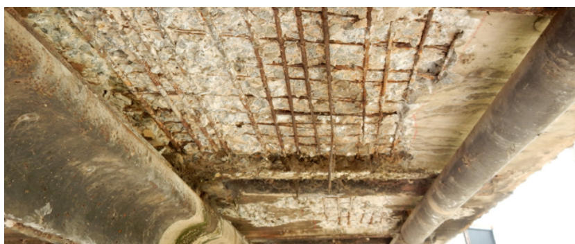
FIGURA 14: SUPERFÍCIE INFERIOR DA LAJE
