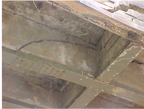
FIGURA 9: VISTA INFERIOR DO ARCO PRÓXIMO AO RECALQUE DO BLOCO DE FUNDAÇÃO
