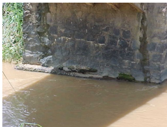
FIGURA 7: Recalque diferencial do bloco de fundação
