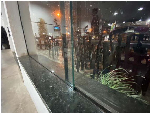
Figura 7. Fresta aparente em uma das esquadrias da fachada, facilitando a passagem do som.
