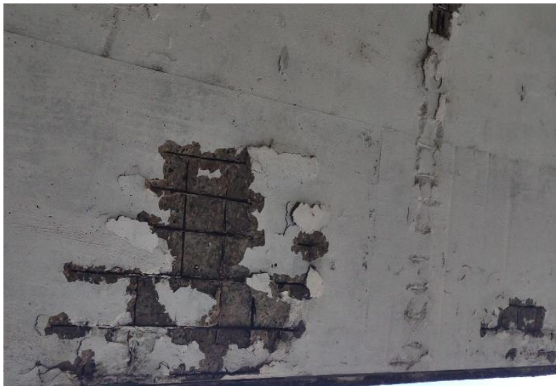
Figura 15 - Laje com deslocamento do cobrimento nominal. Estrutura do caso 5.
