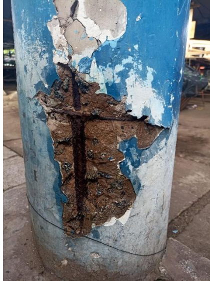
Figura 8 – Concentração de agregados graúdos na base dos pilares em decorrência de segregação da mistura durante a fase de lançamento, ocasionando o enfraquecimento da região
