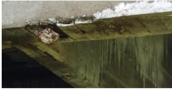
Figura 2 – Corrosão na armadura. Fonte: Macedo [17].
