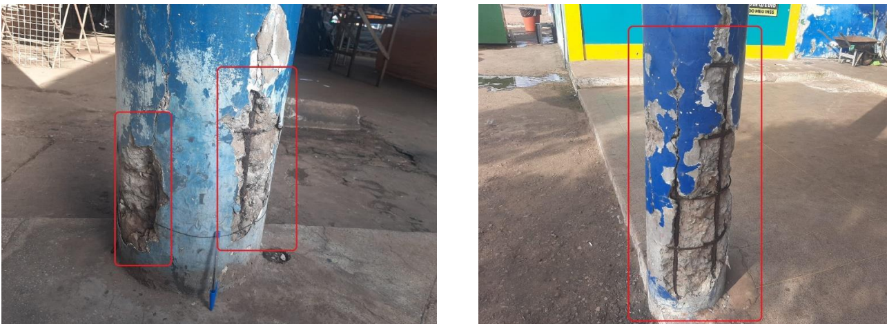
Figura 5 – Desplacamento do concreto e corrosão da armadura dos pilares
