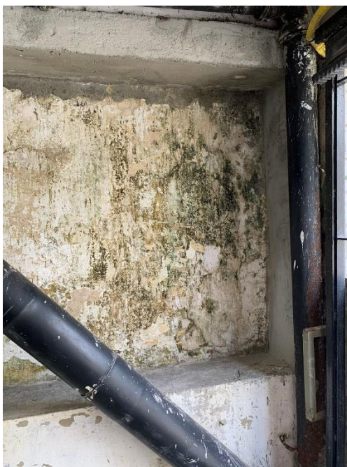
Figura 6 – Formação de bolor na parede do pavimento garagem
