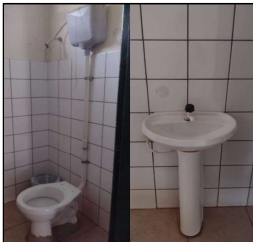
Figura 13 - Acessórios sanitários dos banheiros da praça
