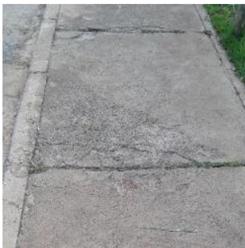
Figura 8: Calçada degradada, amostra região 04.
