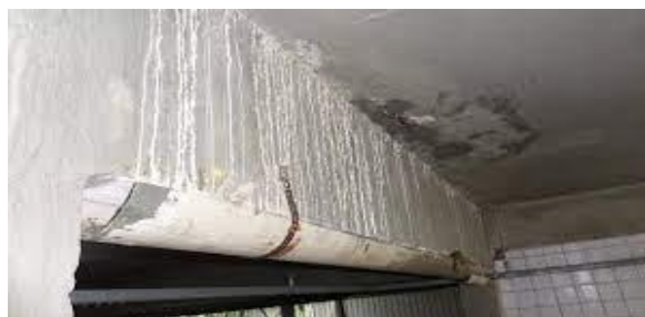
Figura 3 - Lixiviação em ponte de concreto armado. Fonte: Macedo [17].
