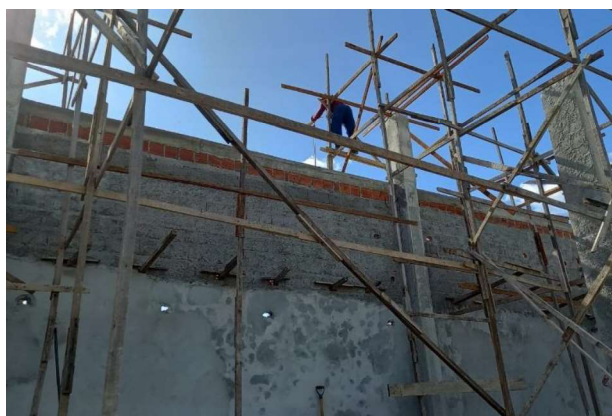
Figura 8 - Trabalhador em altura sem uso de EPI's
