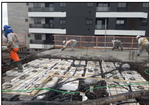
Figura 2 - Passagens elétricas feitas sobre a laje.
