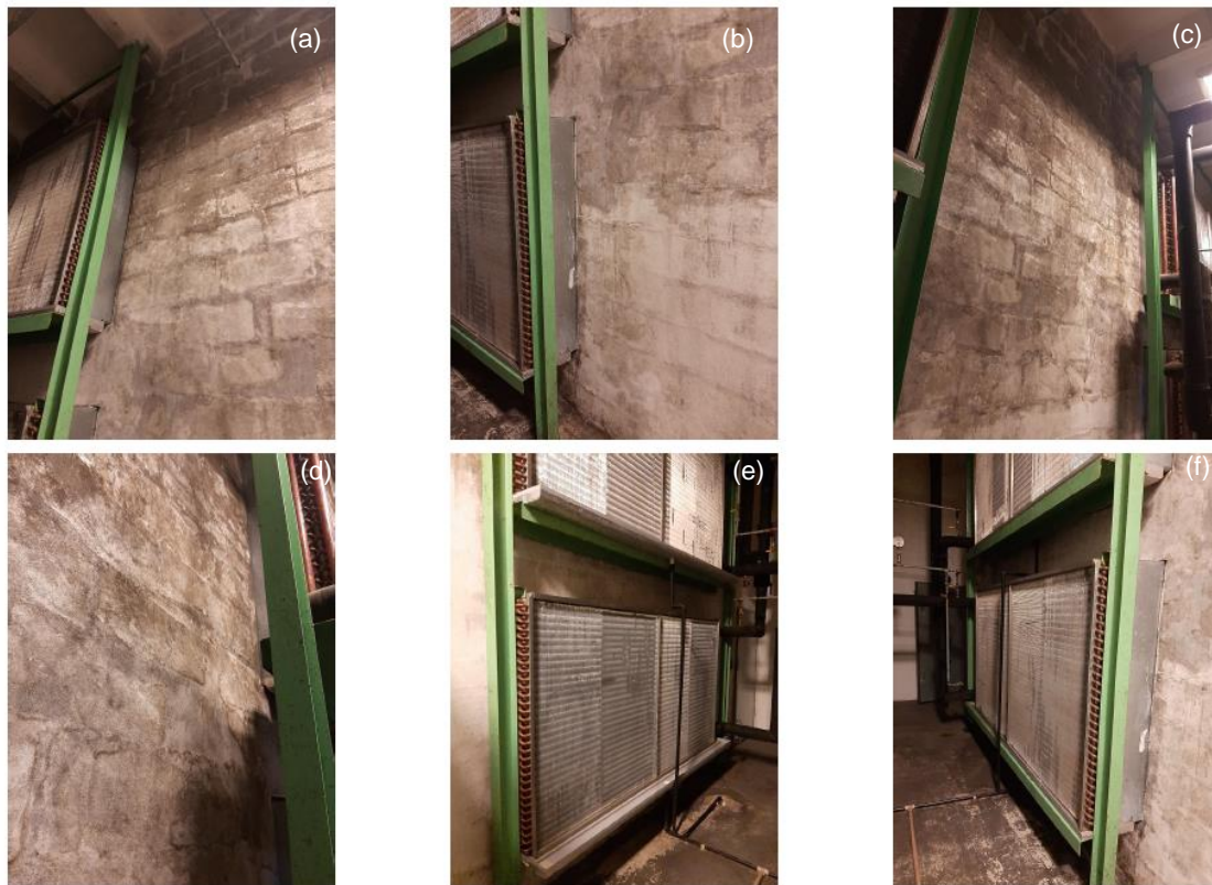
Figura 3 – Locais dentro da central de ar-condicionado com manchas de desenvolvimento de microrganismos.
