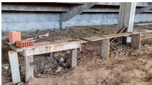
Figura 3 - Central de corte de aço
