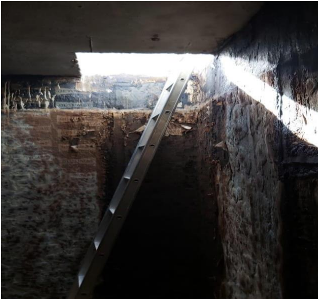
Figura 4 – Descascamento da manta asfáltica estudada.
