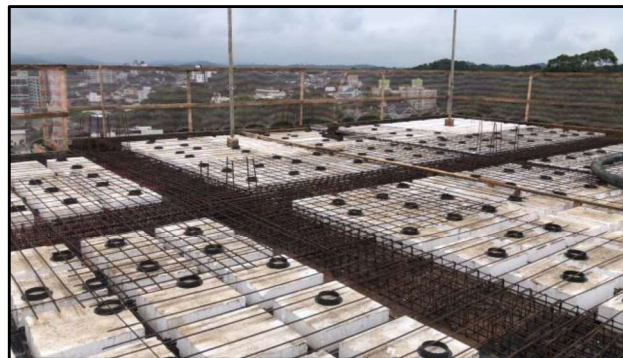
Figura 3 - Passagens elétricas feitas por baixo da laje.
