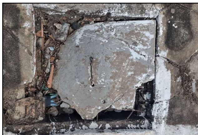
Figura 6 - Estado de conservação das caixas de inspeção
