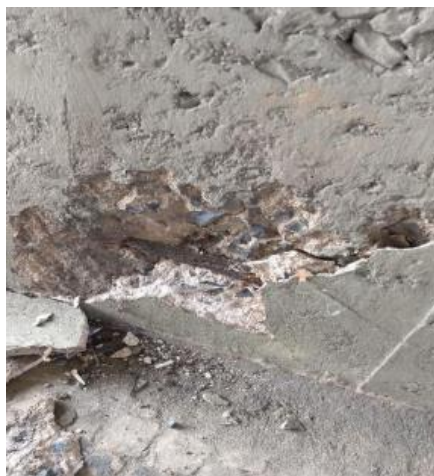
Figura 5 - Desagregação do concreto na base do pilar. Fonte: Silva [21].
