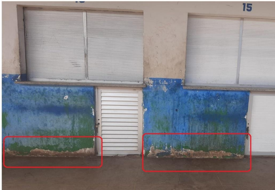
Figura 12 - Ocorrência de desgaste e deslocamento de pintura e revestimento argamassado devido à umidade ascensional.
