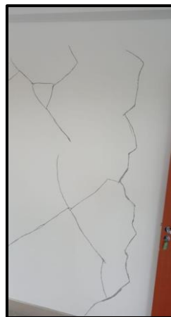
Figura 2. Revestimento fissurado (Obra 2).
