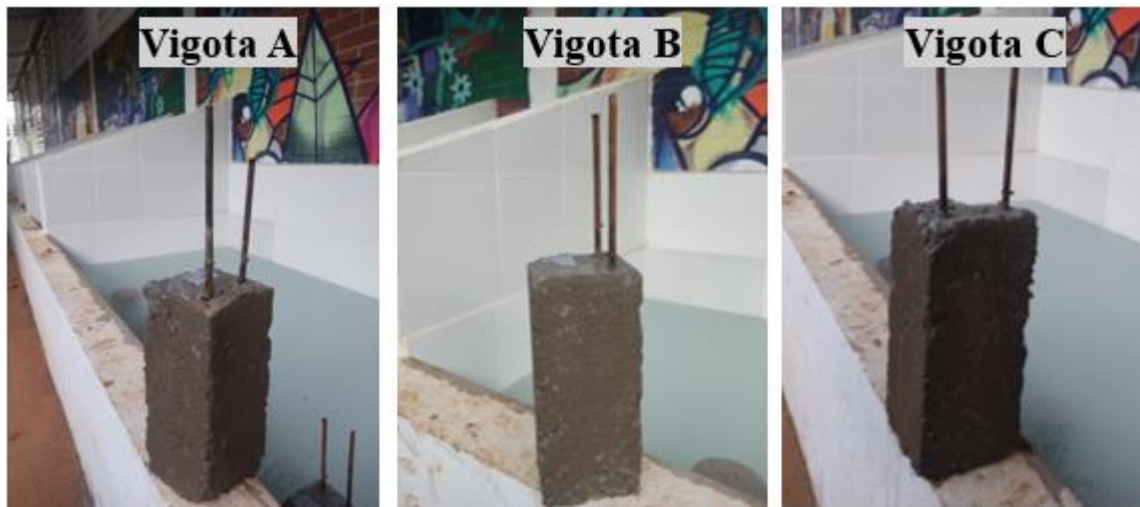
Figura 2 – Vigotas para calibração do aparelho detector de corrosão
