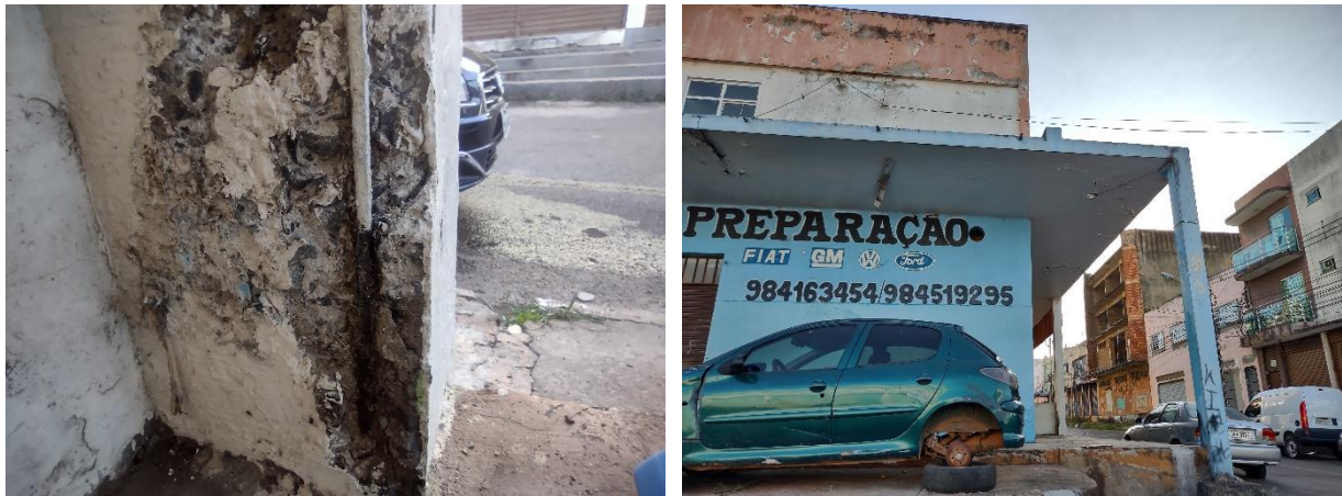
Figura 14 - Pilar e estrutura do estudo de caso 4.
