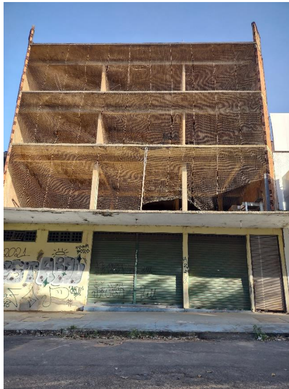
Figura 16 - Edifício abandonado, caso 5.
