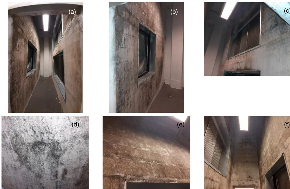
Figura 4 – Locais dentro da central de ar condicionado e casa de máquinas com manchas de desenvolvimento de microrganismos e manchas de umidade.
