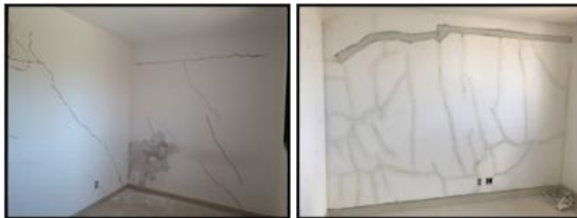
Figura 4. Revestimentos fissurados (Obra 9).
