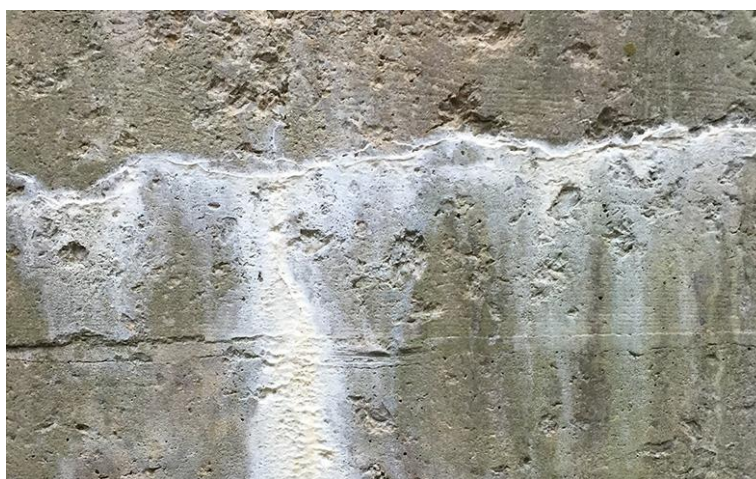
Figura 2 – Eflorescência em parede de alvenaria [6]
