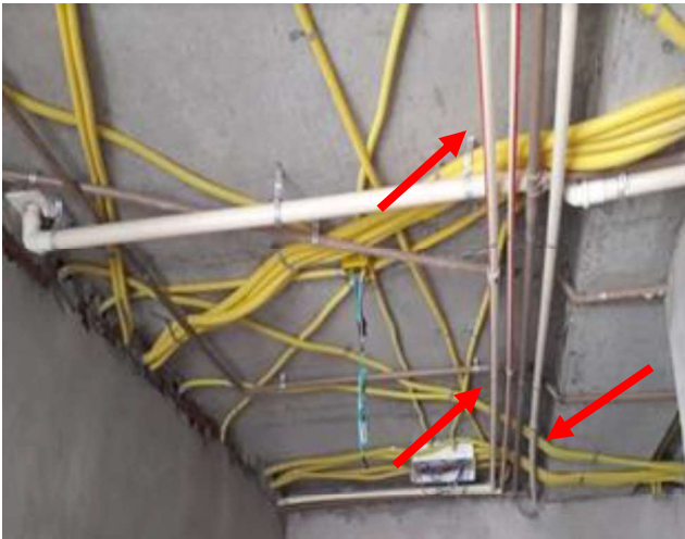
Figura 3 – Tubulações instaladas e fixadas sob esforço, na Torre A.
