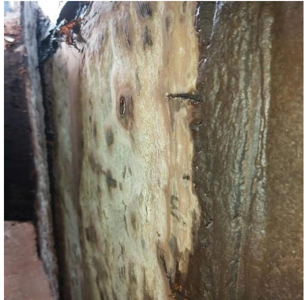
Figura 5 – Rasgos na manta asfáltica estudada.
