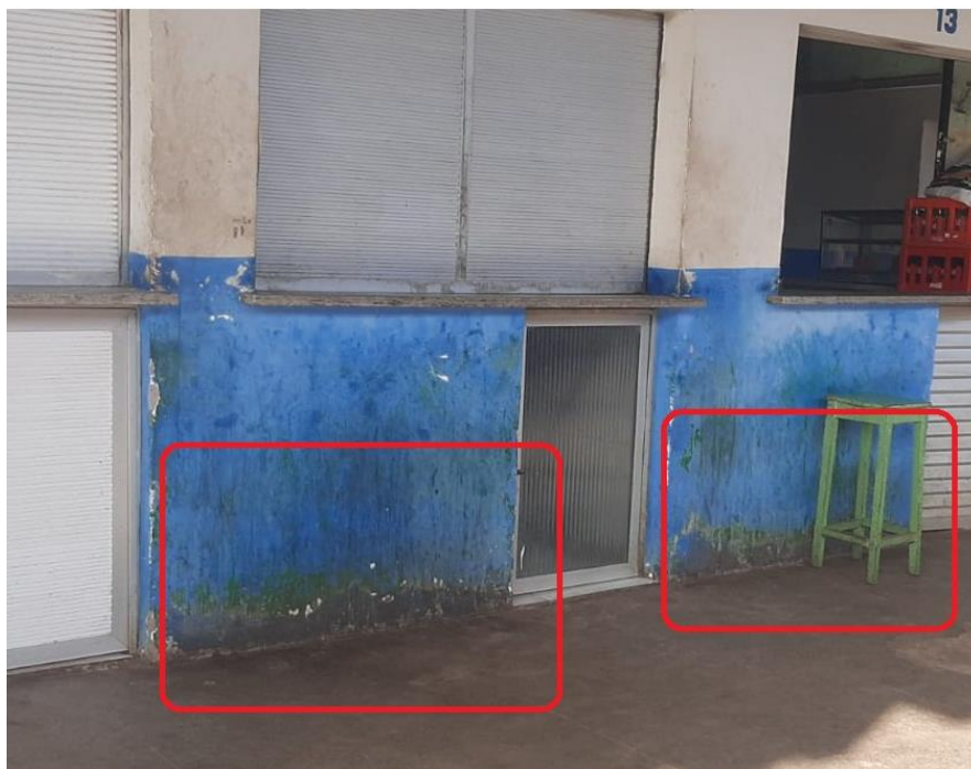
Figura 13 - Aparecimento de manchas e bolores nos revestimentos.
