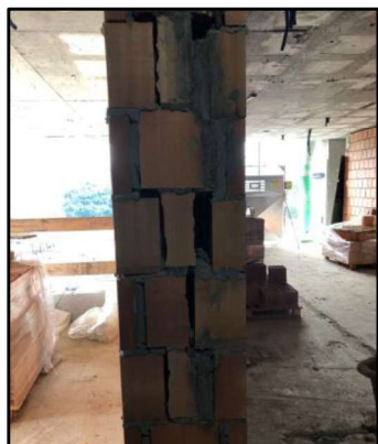
Figura 5 - Baixa qualidade da alvenaria.
