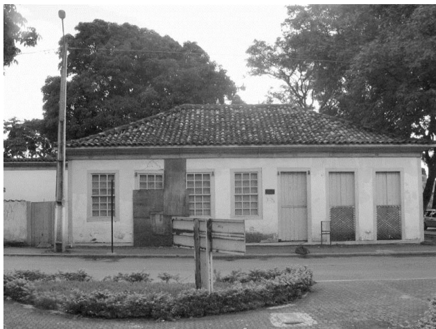
Figura 4 – Museu de História e Arte de Planaltina e sua fachada danificada
