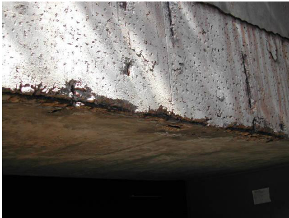
Figura 15 – Processo de corrosão da armação. Laje do mezanino da Ala Sul – ICC
