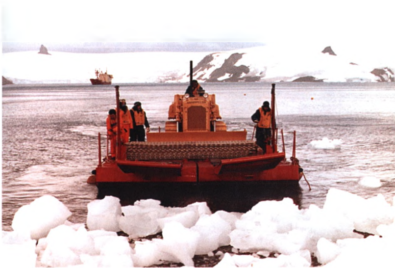
Figura 1: A chegada da balsa com o trator dá início ao trabalho de montagem da Estação
