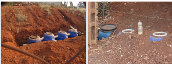
Figura 50 - Tratamento de esgoto através de biodigestor. Fonte: Imagem obtida do relatório final do Grupos 5 no curso EPAATHIS, promovido entre agosto/2020 e out/2020
