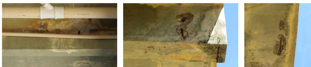
Figura 32 – Eflorescência | Figura 33 – Desagregação | Figura 34 – Corrosão. Fonte: Acervo do Autor
