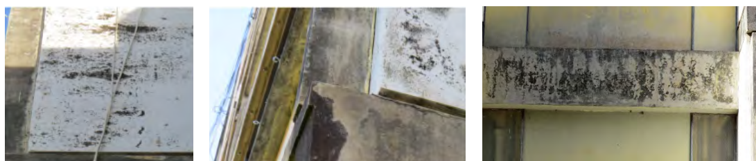
Figura 26 – Manchas | Figura 27 – Manchas | Figura 28 – Eflorescência. Fonte: Acervo do Autor
