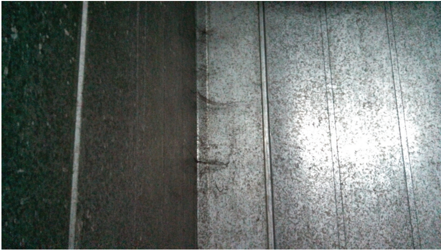
Figura 4.13. Cámara frigorífica, sector cocina. Complejo Penitenciario San Martín, 2014.
