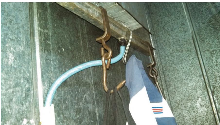
Figura 4.15. Cámara frigorífica, sector cocina. Complejo Penitenciario San Martín, 2014.
